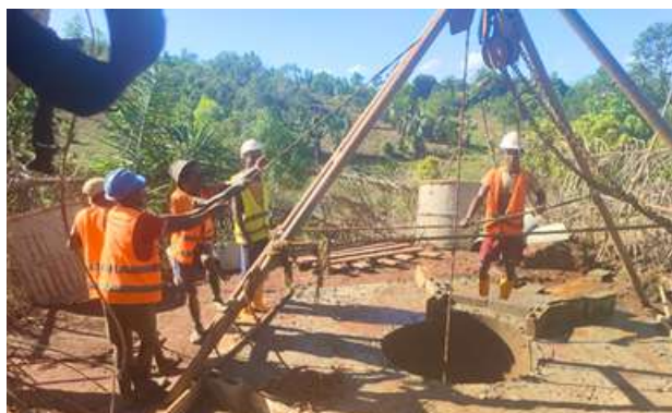
Construction d'un puits avec pompe à motricité humaine à Tajondava, commune d'Ivandrika, région Atsimo-Atsinanana
