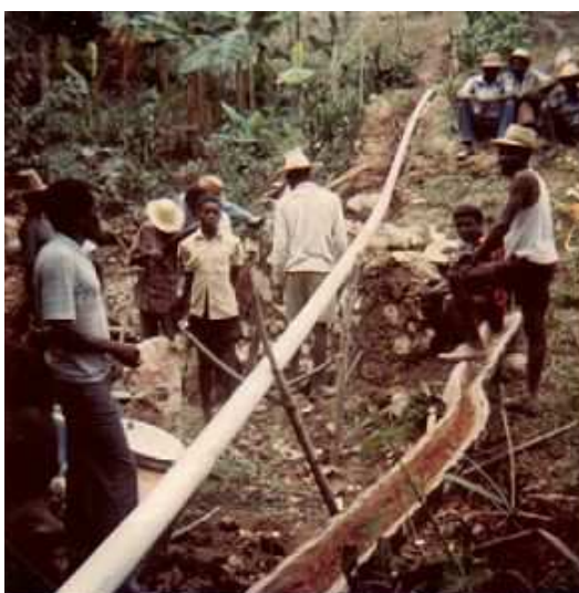
Une des adductions réalisées en 1987 à Bodarie, en Haïti.
